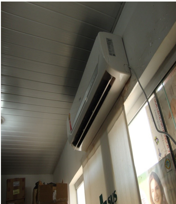
Refrigeração do ambiente da Farmácia Central
